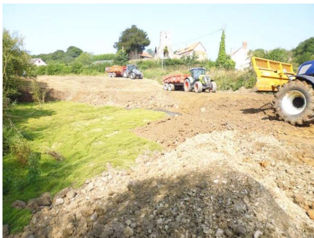
Figure 20 : Travaux de comblement d'un bras mort de la Vire, Basse-Normandie. © CEN Basse-Normandie
